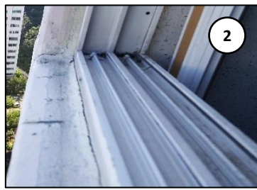
<낮은 품질 퍼티의 균열>
