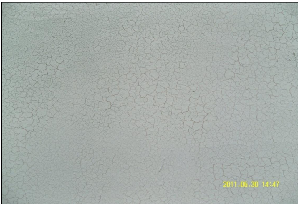
하도재로서 믹싱도장후 수성페인트 도장시 수성페인트 표면 균열 발생 2
