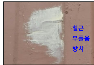
하도재 및 바탕처리 누락부위 부실시공 ; 하도재공정 생략
