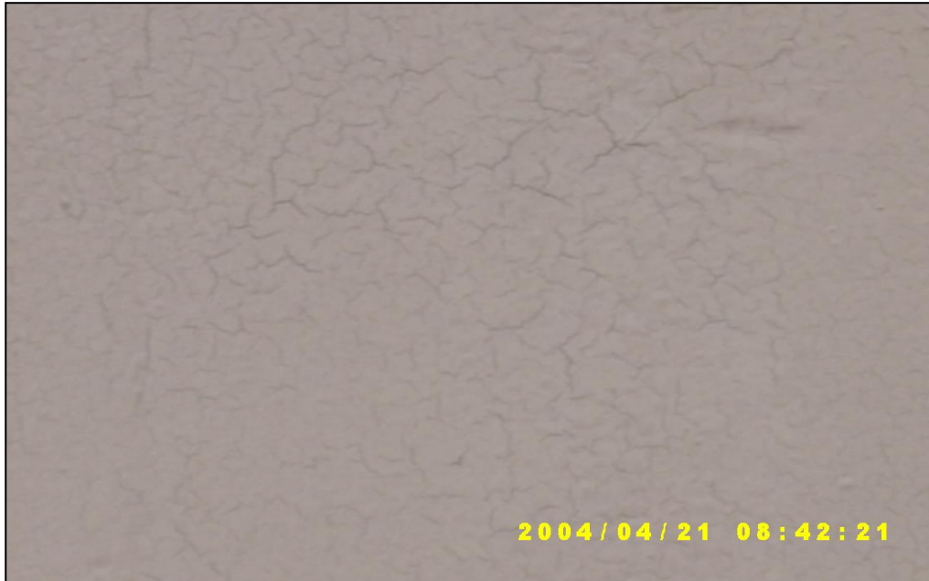
하도재로서 믹싱도장후 수성페인트 도장시 수성페인트 표면 균열 발생 1
