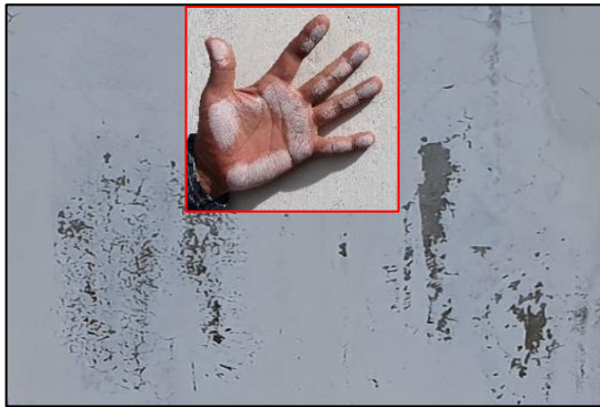
<외벽페인트 부식 상태>
