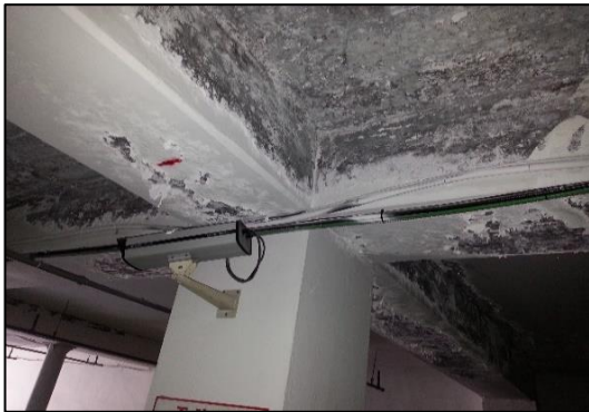
공극 누수유입 및 철근 부식 이동누수"㉠"
