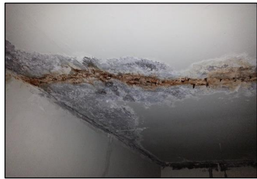
균열누수 및 철근부식 이동 누수"㉡"
