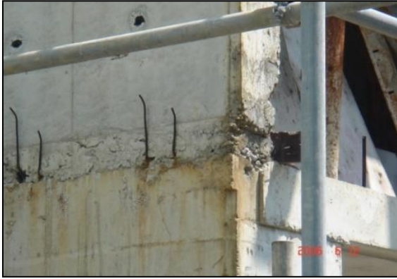
콘크리트 속의 자갈몰림 공극
